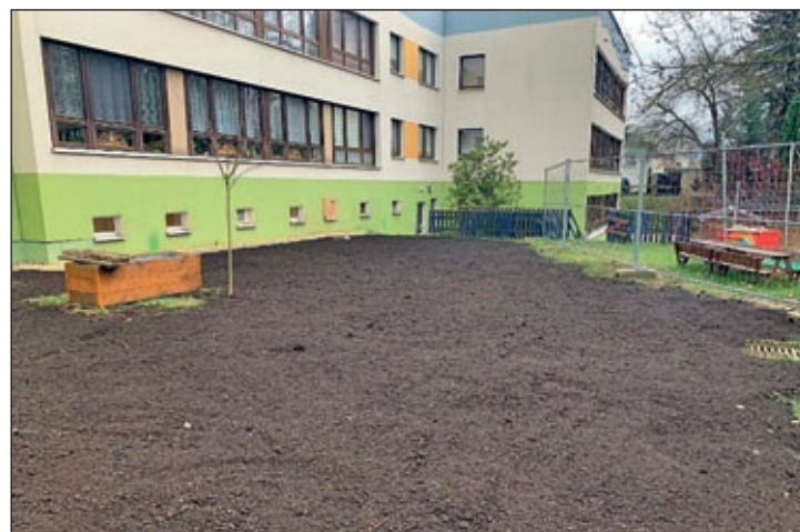
Aktuell finden noch Baumaßnahmen in den Außenanlagen der Kita Regenbogen statt, die sich im Abschluss befinden, wie hier zu sehen.
